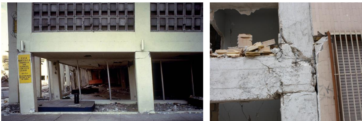
1-сүрөт. Каркас конструкциясынын сейсмикалык бузулушу
