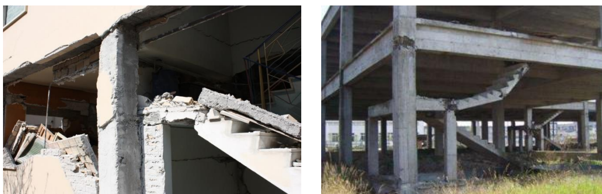
2-сүрөт. Каркас конструкциясындагы тепкичтердин сейсмикалык бузулушу
