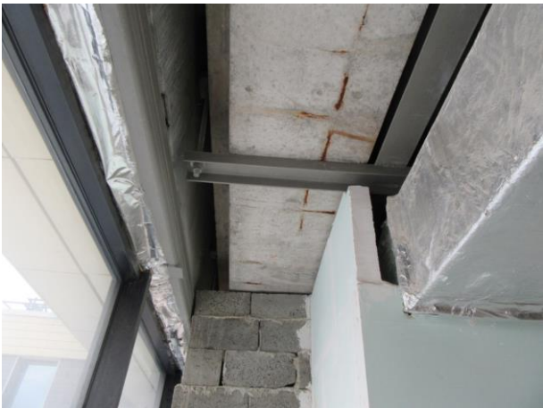
Рисунок 1 - Коррозия арматуры ригеля в осях «Г/14-16»
